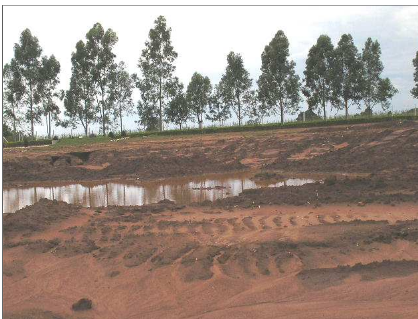
Figura 18: Vista parcial de um empocamento na parte frontal do aterro Fonte: Albertin, R.M., 2008
